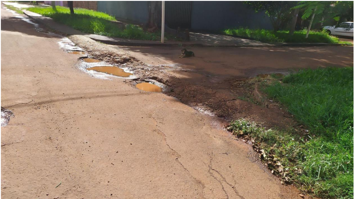
Figura 13 - Vistas de uma lombada construída pelos moradores para diminuir ou barrar o fluxo da água no loteamento Jardim Pantanal, rua Airton Senna.
